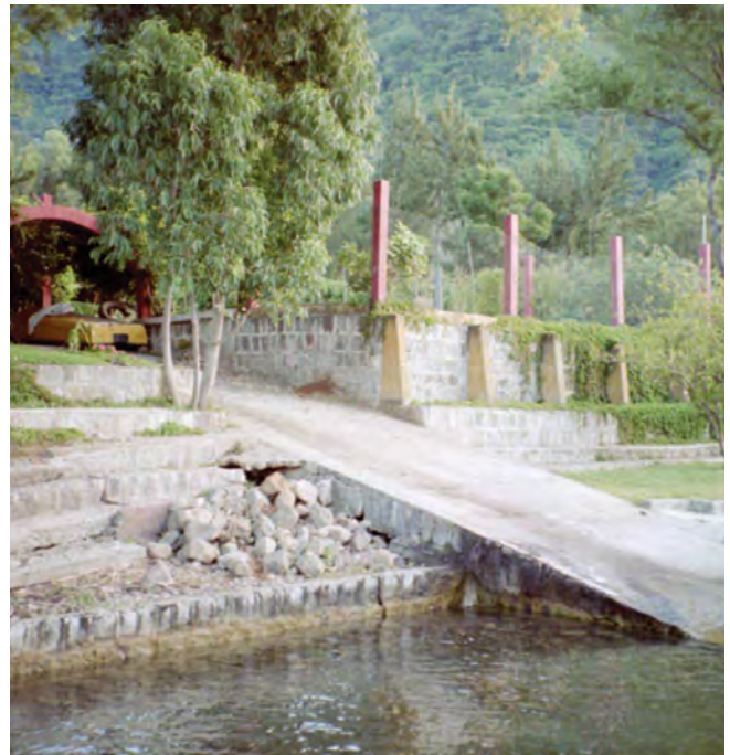
Accès restreint dû à des barrières et une rampe à San Marcos La Laguna, Guatemala © Sandra De Urioste-Stone.
